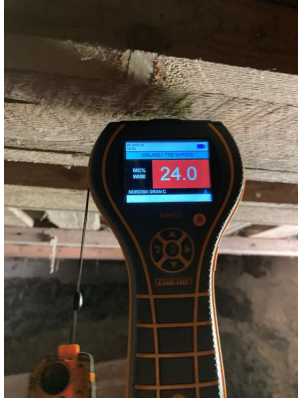
Fuktmåling i stubbeloft fra krypkjeller.
