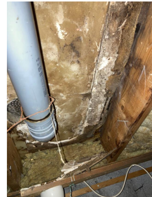
Avløpsrør fra sluk på bad i første etasje.
