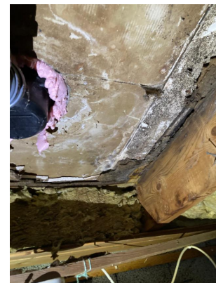
Tidligere vannlekkasje fra bad i første etasje.
