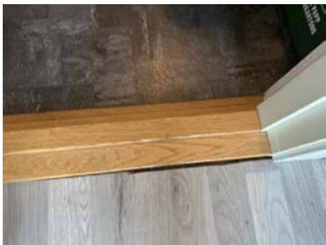
Manglende avslutning av laminat ved dører.
