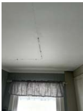
Merker etter ledning i tak på kjøkken.
