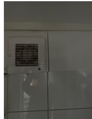
Avtrekk på bad/vaskerom.
