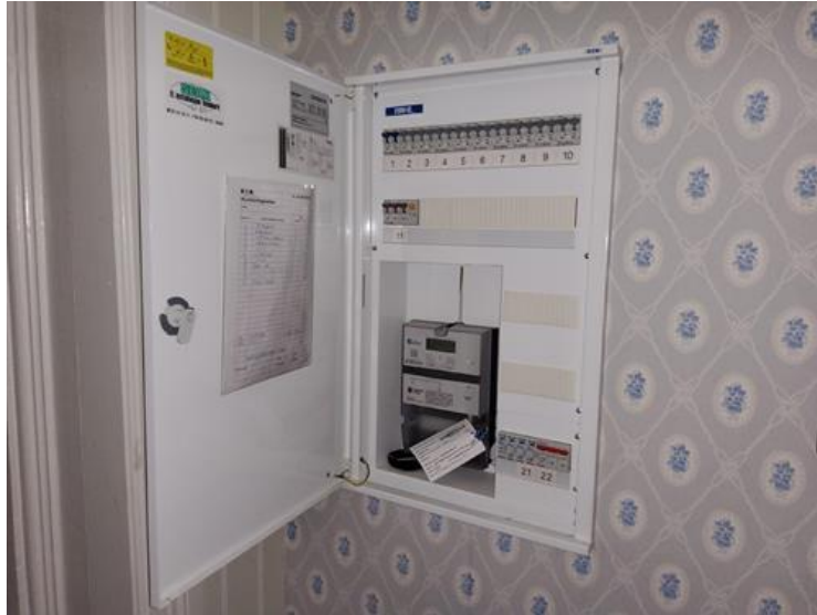
Elektrisk anlegg - [Sikringskap]
