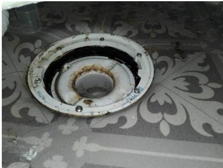
Avløpsrør (ink. sluk) - [Sluk bad]
