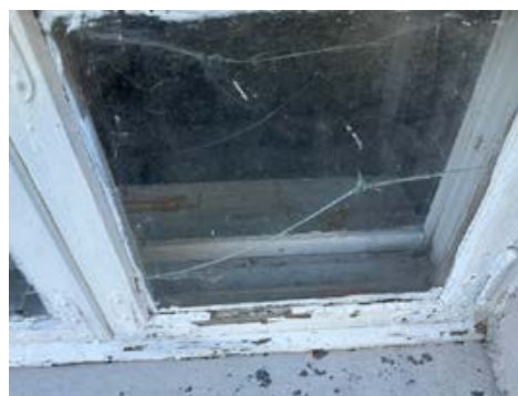
Vedlikehold av vinduer må regnes med.
