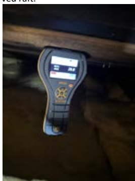
Høye fuktverdier i takbord på loft.
