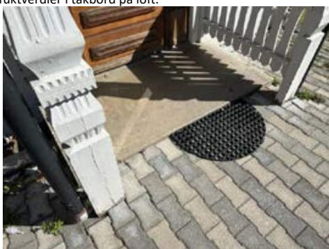
Treverk ved inngangsparti må males.
