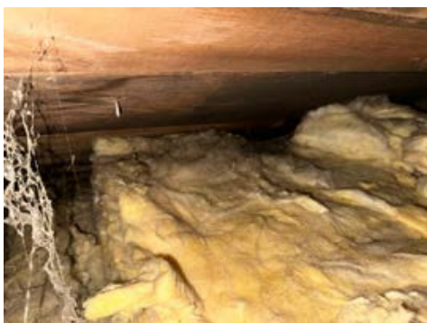
Manglende lufting ved raft.
