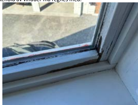
Innvendig fukt slitasje i vinduer.
