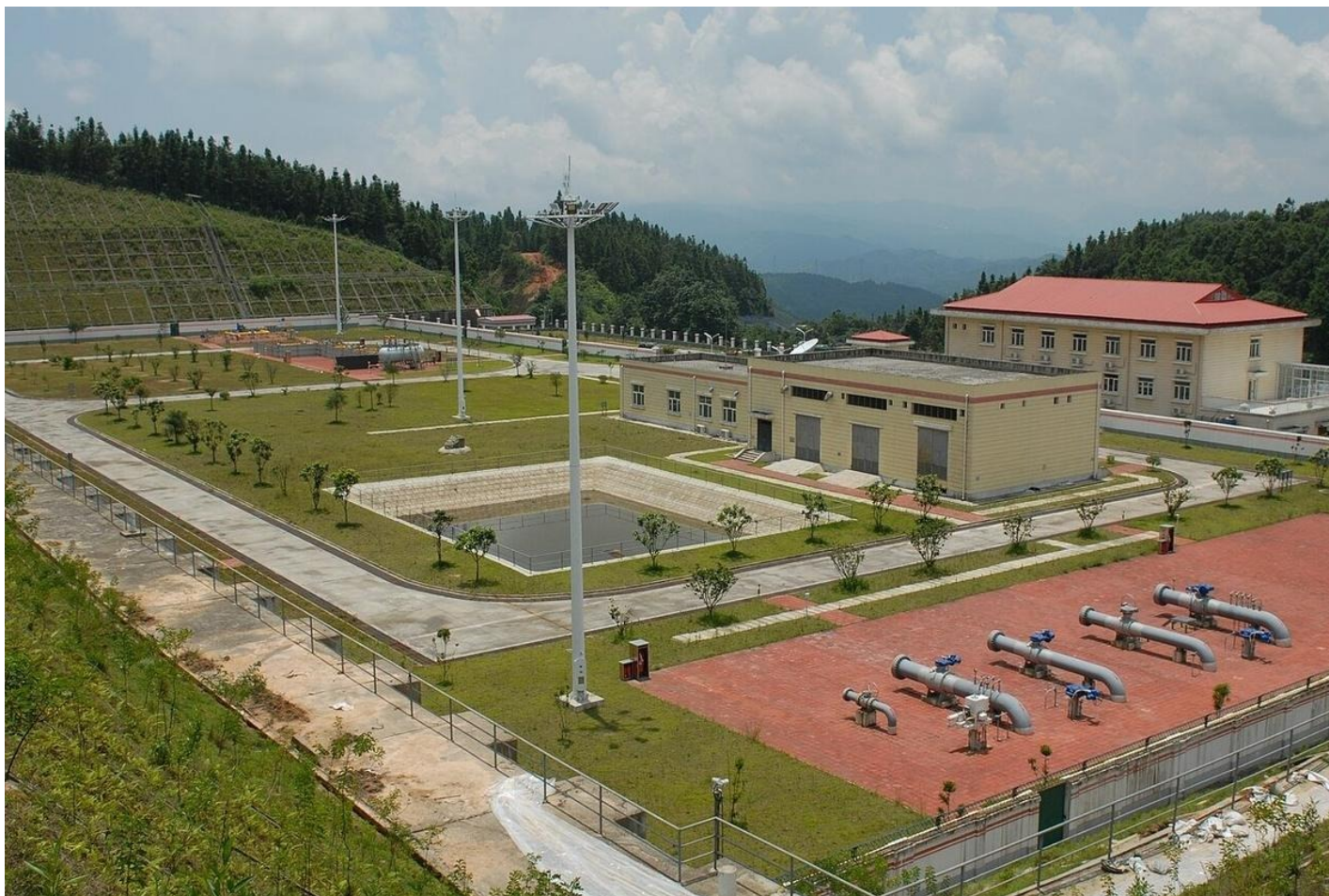
Насосная станция газопровода Мьянма — Китай. Источник: Википедия
