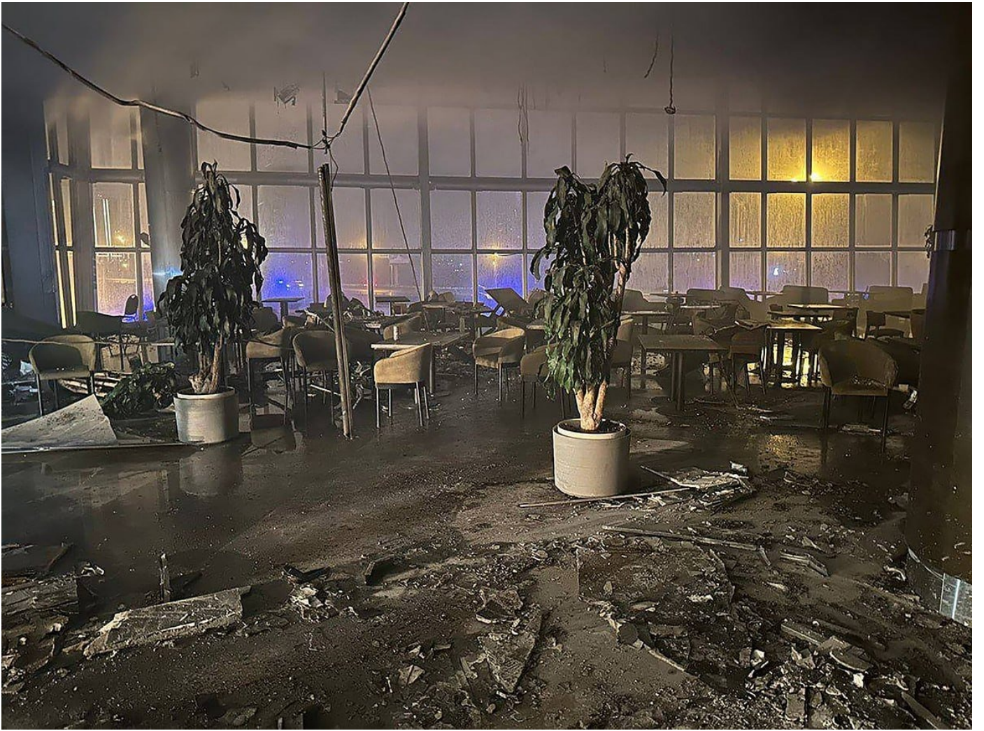
Вид на «Крокус Сити Холл» внутри после локализации возгорания. Фото: пресс-служба губернатора Подмосковья
