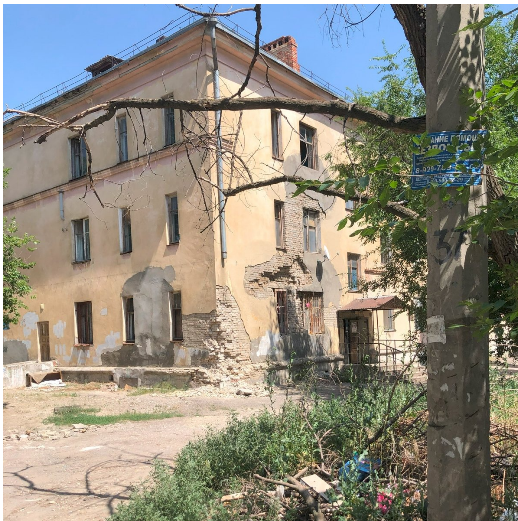
Дом с обваливающимся фасадом. Фото: Вадим Таринцев
