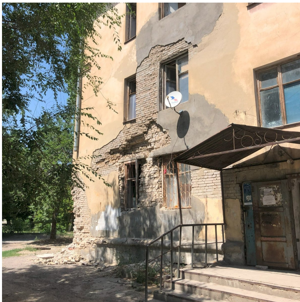
Дом с обваливающимся фасадом. Фото: Вадим Таринцев
