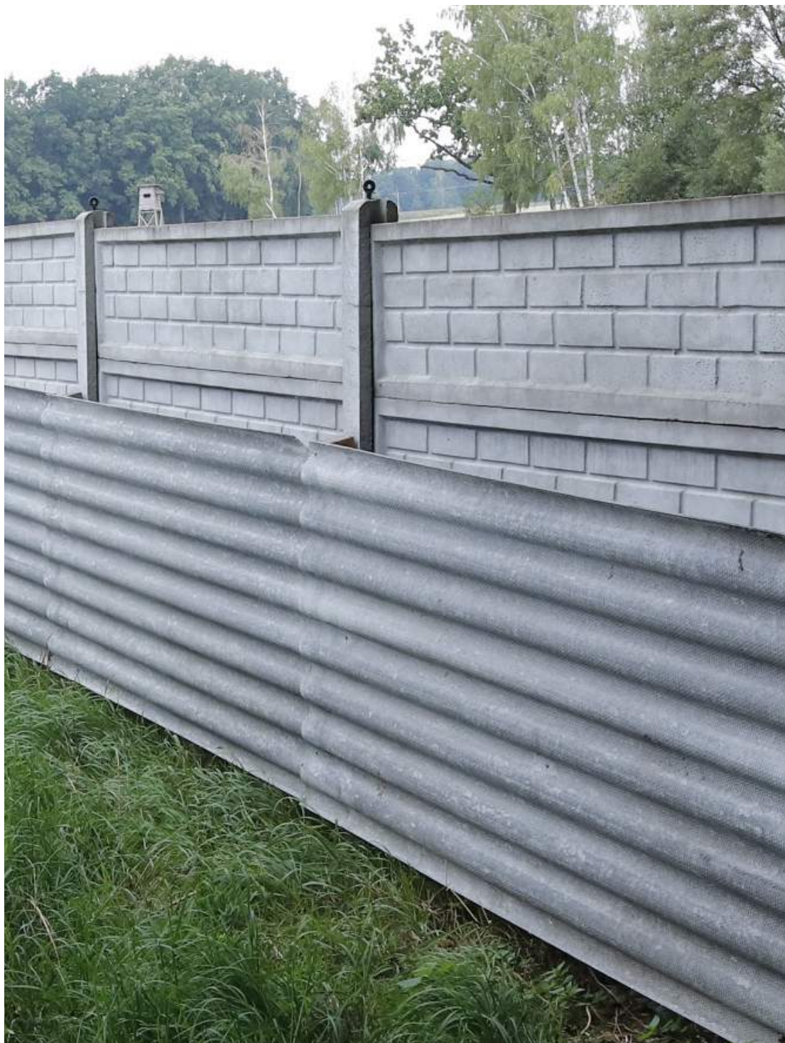
Ferma w Lublińcu (woj. śląskie) - opłotowanie nie jest osadzone w podłożu, miejscami nawet 20 cm nad powierzchnią.
