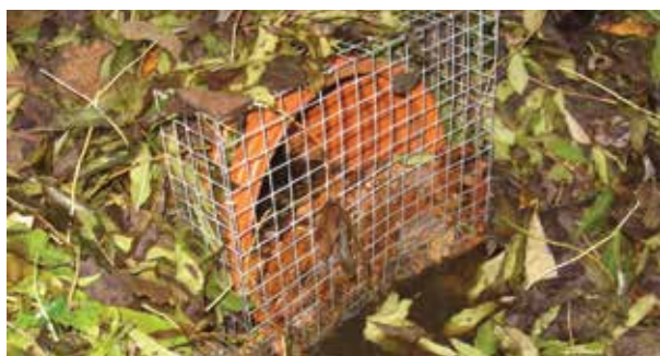
Zamaskowany odpływ ścieku w Szymankowie, 2010, zdj. www.murowana-goslina.pl
