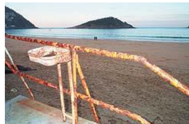
Corrosión de un metal
