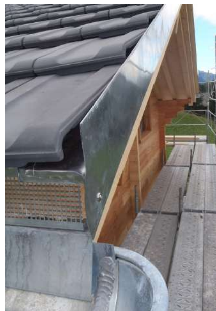
Abbildung 6: Dachrinne MFH, Archiv Holzbau AG
