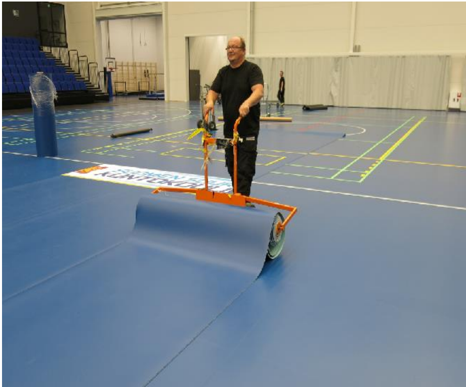
Kuva 27: Mattovuodan avaaminen matonlevityslaitteella ”peruuttamalla” ja samalla maton asennuskohtaa hienosäätämällä laitetta ohjaamalla onnistuu yhden asentajan/henkilön voimin.
