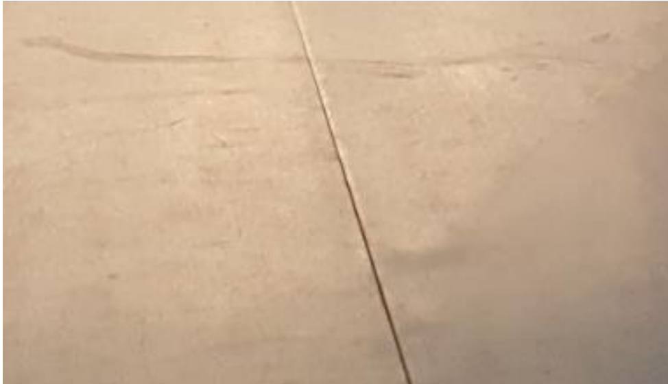
Kuva 38: Auenneen mattosauman korjaaminen vaatii alla olevan saumateippauksen uusimisen. Pikakorjauksena voidaan tarvittaessa asentaa kirkas teippi päälle.
