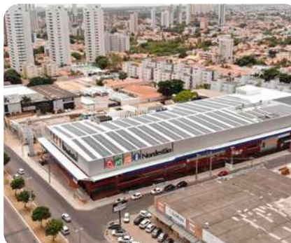
Gerador fotovoltaico comercial de 492 kWp - RN
