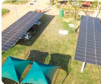
Gerador fotovoltaico para garagem de 40 kWp - ES
