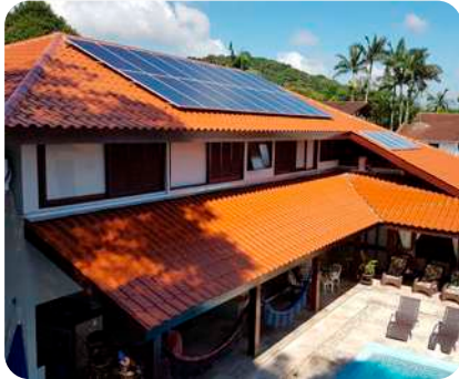
Gerador fotovoltaico residencial de 6,12 kWp - SC
