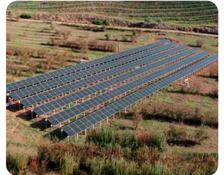
Gerador fotovoltaico para solo de 132 kWp - RS
