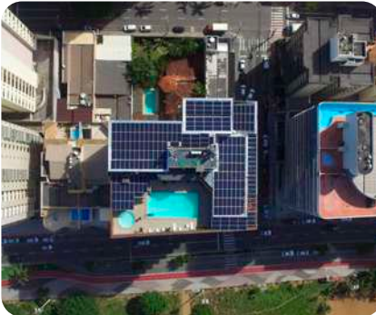
Gerador fotovoltaico em condomínio de 90 kWp - ES
