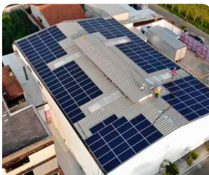
Gerador fotovoltaico industrial de 56 kWp - RJ
