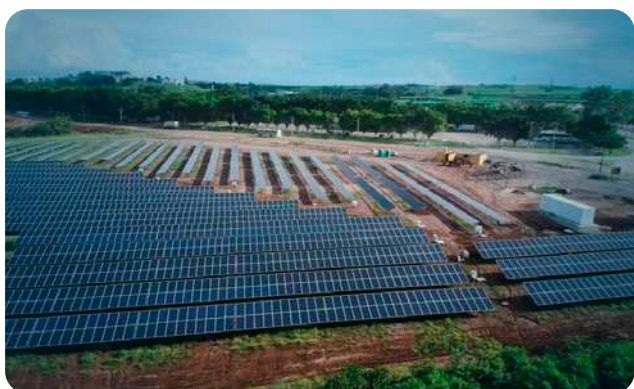
UFV RAÍZEN - 1.267,00 kWp
