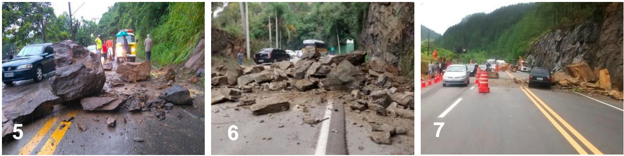
Figura 5 – Rompimento de talude no km 120 – março de 2016 (Portal Fotos Públicas, 2016). Figuras 6 e 7 – Rompimento de talude no km 117 – setembro de 2015 (Folha do Litoral Norte, 2015 b).
