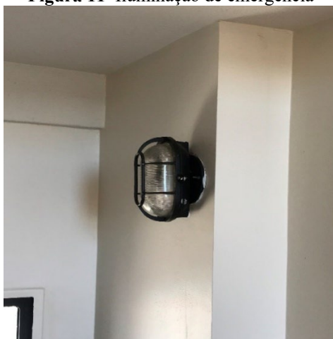
Figura 11 –Iluminação de emergência
