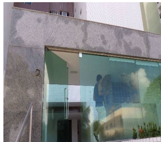
Figura 15: Infiltração no revestimento
