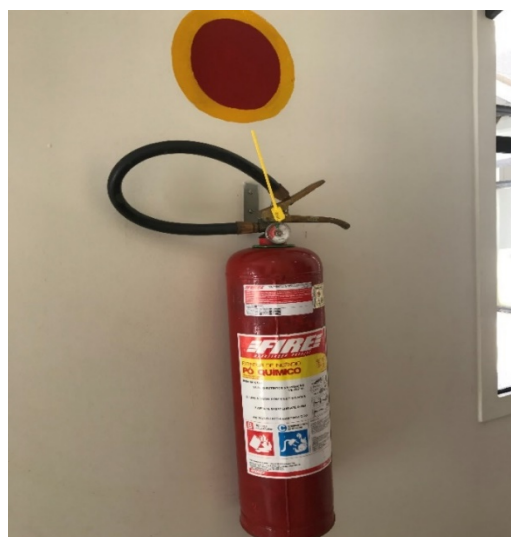
Figura 13 –Unidade extintora Classe B e C
