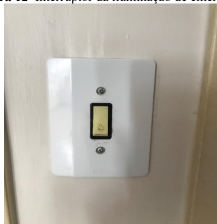
Figura 12 –Interruptor da iluminação de emergência
