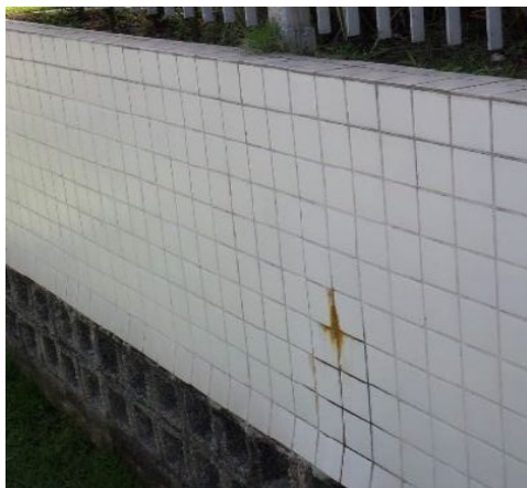
Figura 14: Infiltração no revestimento
