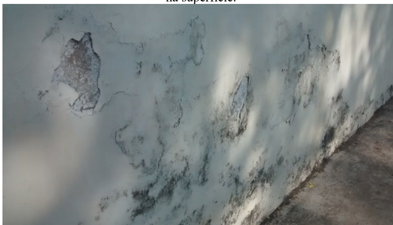
Figura 1: Eflorescência causando bolhas (descolamento) da pintura e mofo devido a ação constante da umidade na superfície.
