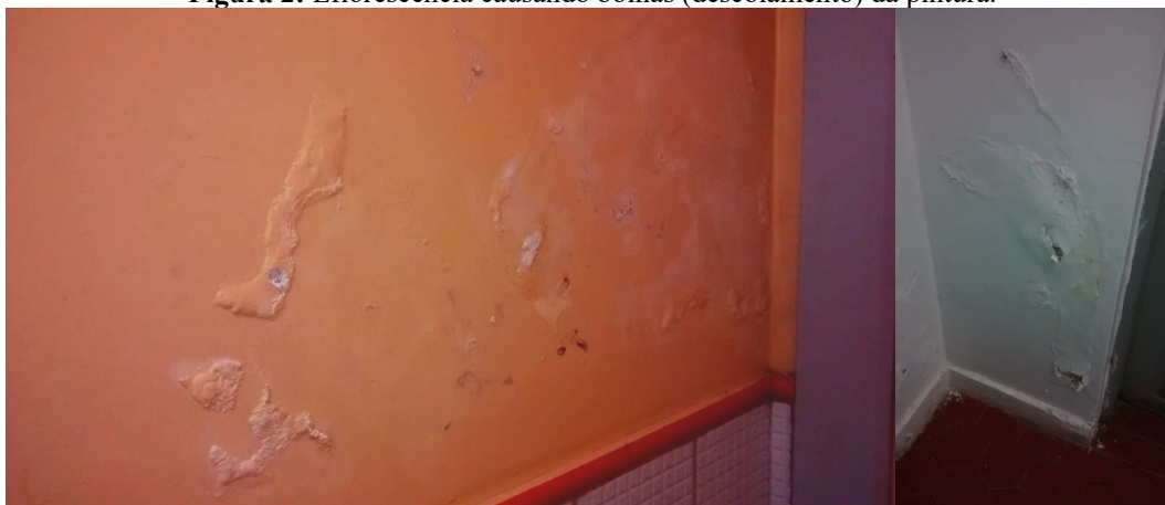
Figura 2: Eflorescência causando bolhas (descolamento) da pintura.
