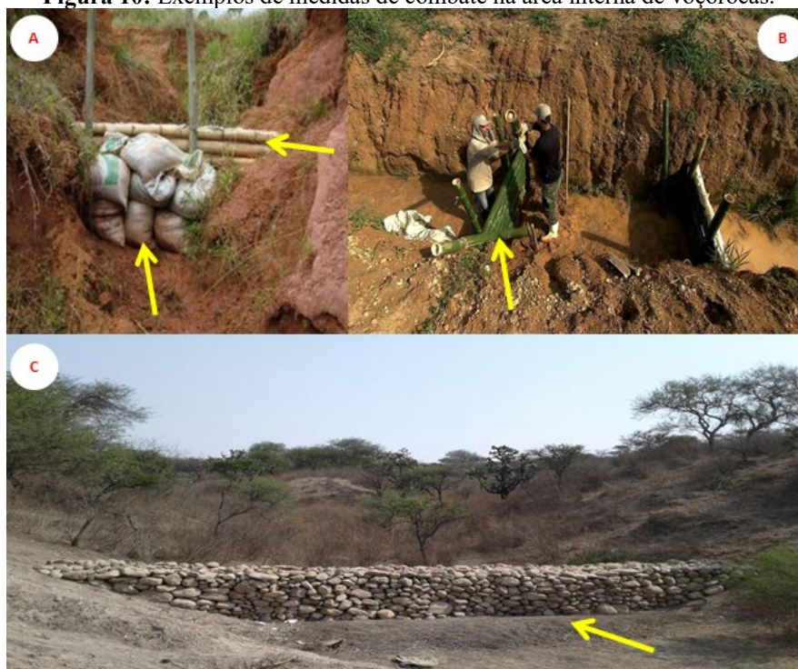
Figura 10: Exemplos de medidas de combate na área interna de voçorocas.
