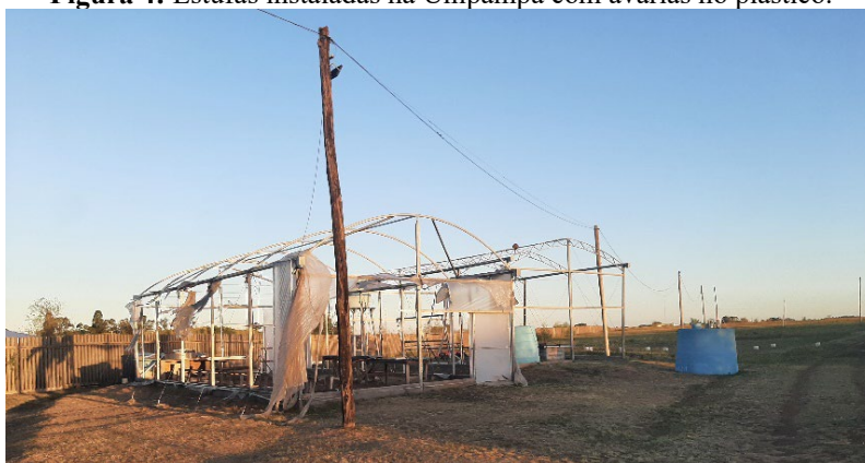
Figura 4: Estufas instaladas na Unipampa com avarias no plástico.
