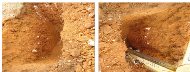
Figura 2 - A direita trincheira aberta com profundidade 350 cm e a esquerda trincheira sendo aberta pela retroescavadeira.
