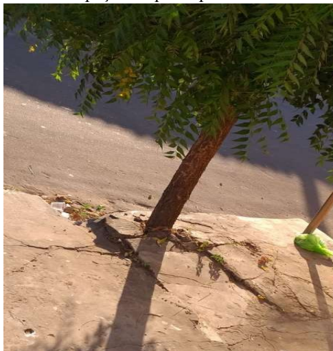
Figura 3: Falta de espaço adequado para o crescimento das raízes
