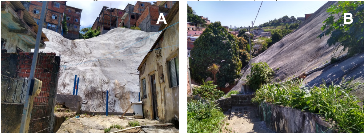
Figura 15 - Encostas com contenção de geomanta (A e B).
