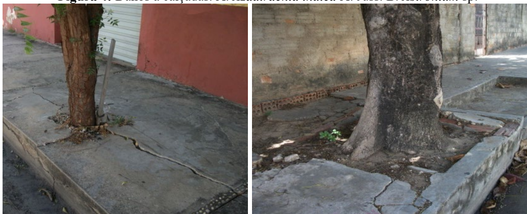
Figura 4: Danos a calçadas. A. Azadirachta indica A. Juss. B. Astronium sp.
