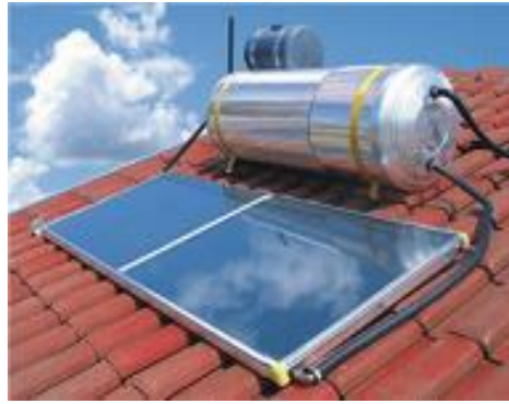
Figura 1 - Coletor solar utilizado em casa residência.
