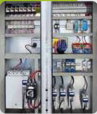
ELEKTRİK PANOSU ELECTRICAL PANEL
