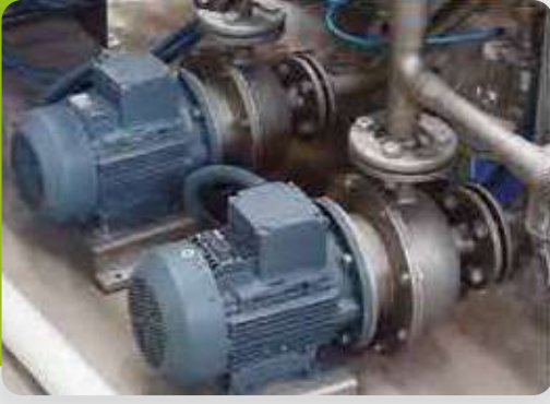
DOZAJLAMA POMPASI DOSING PUMP
