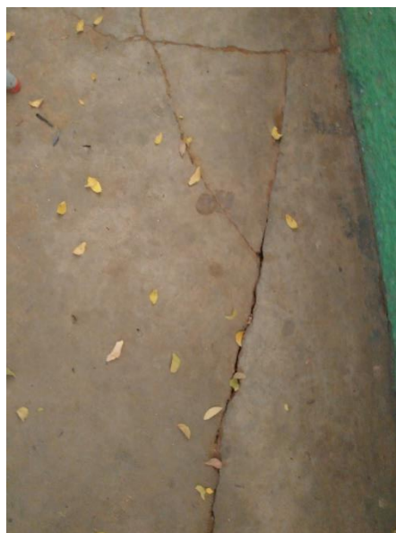
Figura 5 – Fissura em piso
