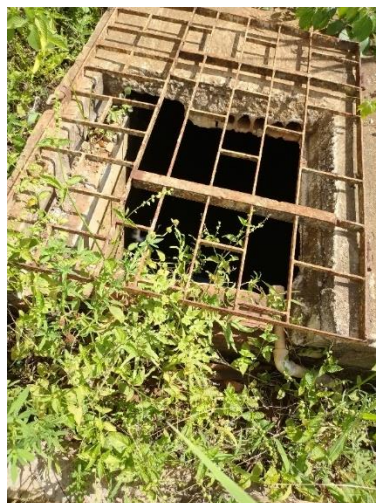
Figura 6 – Reservatório exposto a contaminação
