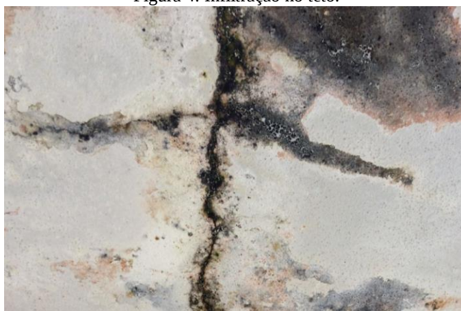
Figura 4: Infiltração no teto.
