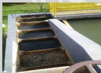
Estação de tratamento de Jussara
