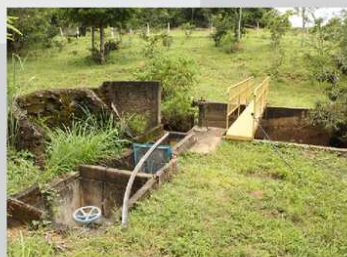
Captação de Água em São Francisco
