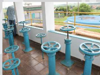
Estação de tratamento de água de Carmo do Rio Verde
