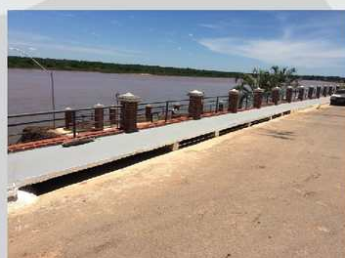
Rede pluvial de Aruanã
