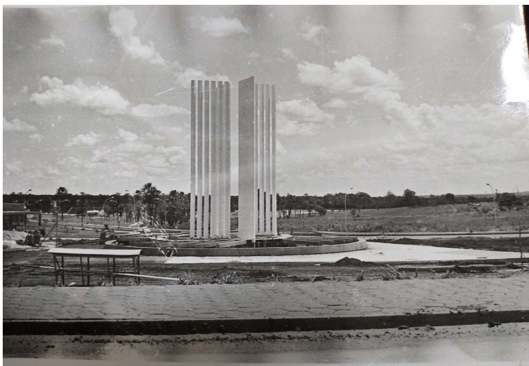
[Figura 15] Vista da construção do paliteiro, localizado na fachada principal da UFMS, Campo Grande, MS.
