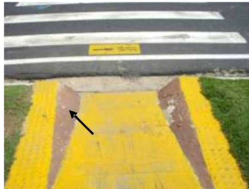
Figura 8: Piso tátil com rampa inacessível
