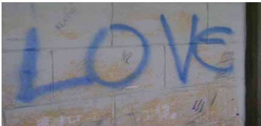
Figura 2 - Parede interna pichada e rabiscada
