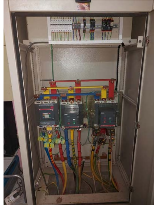
Project Name: ATS retrofit and MV SWG Client : جهاز مشروعات الخدمة الوطنية Scope of work : Supply of ATS panel in the HQ building.
