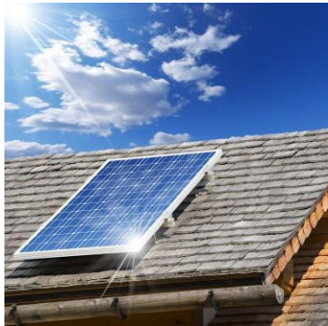
Panneau solaire sur le toit
