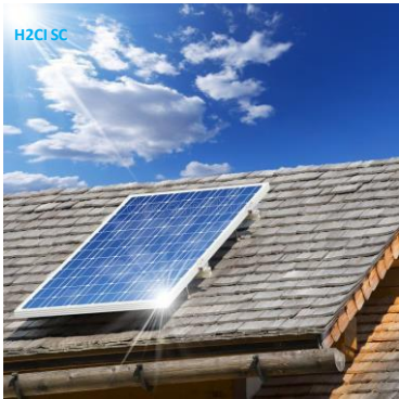
Panneau solaire sur le toit
