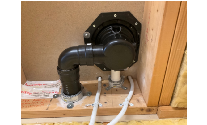
Avløpsrør fra sluk i vaskerom ligger i skillevegg mellom boenhetene. Avløpsrør er påmontert brannmuffer. Avløpsrør og sluk må kontrolleres av rørlegger før himling og vegger lukkes.
