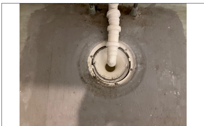
Sluk på vaskerom.
