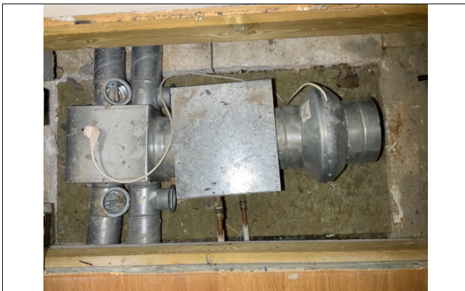
Fjernvarmeanlegg i gulv.
