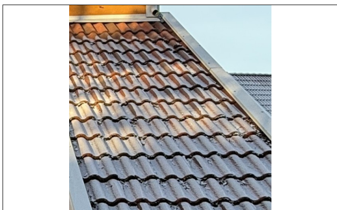
En god del mose på takstein på begge sider av huset. Trenger å rengjøres.
