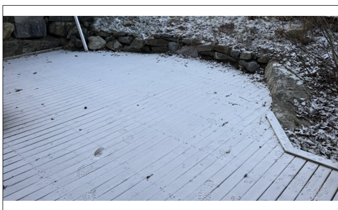
Slitte terrassebord på baksiden huset.
