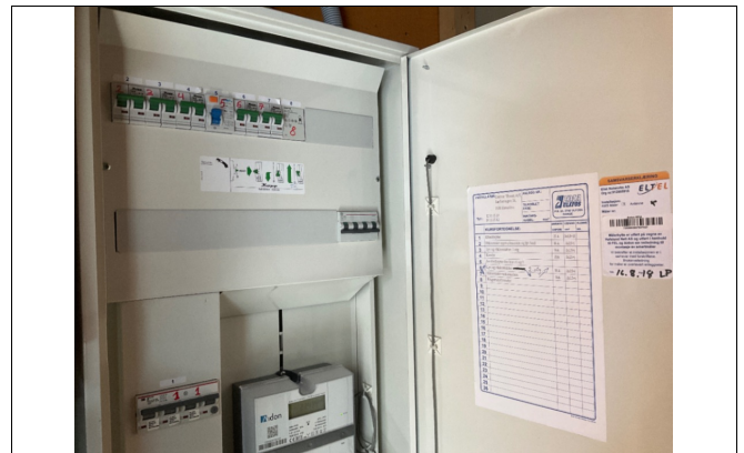
Sikringskap med kursfortegnelse.
