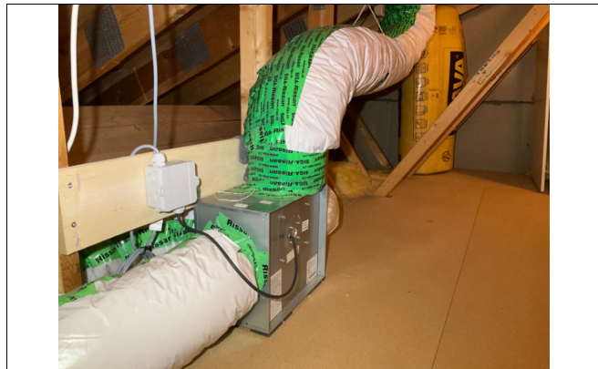
Ventilasjonsanlegg på kald loft.
