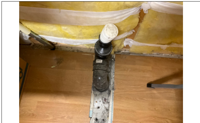
Rørproplegg på kjøkken.
