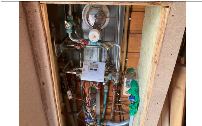
Fjernvarmeanlegg med måler i bod.
