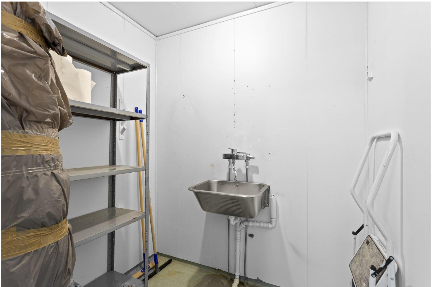
Vaskerommet i 2. etg må pusses opp. Eier har kjøpt inn masse oppussingsmaterialer, se salgsoppgaven.
