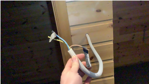
Løse ledninger ut fra trekkerør.
