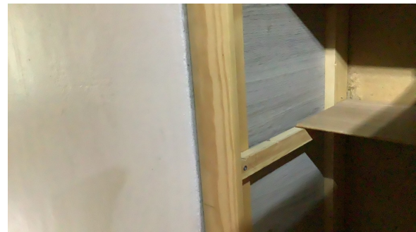
En pipevange er innkledd i skap.
