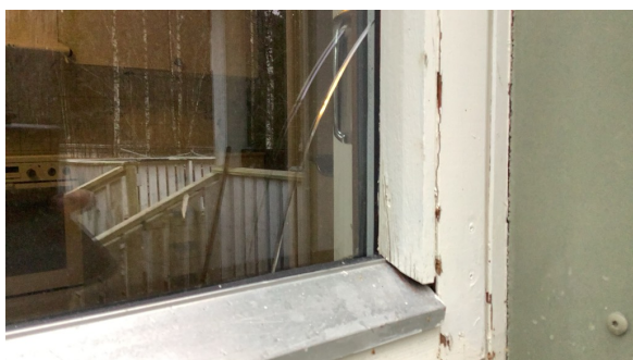
Sprukket glass i vindu.
