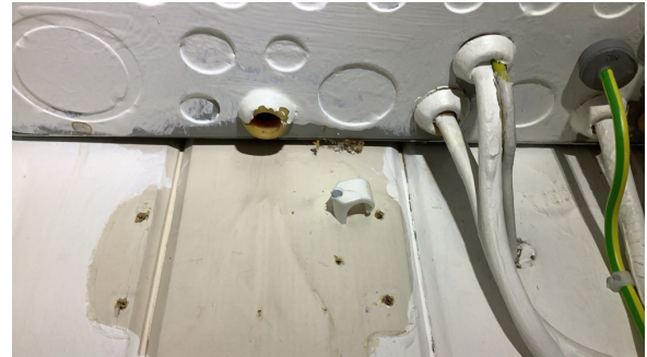
Utett kabelinnføring i sikringskap.
