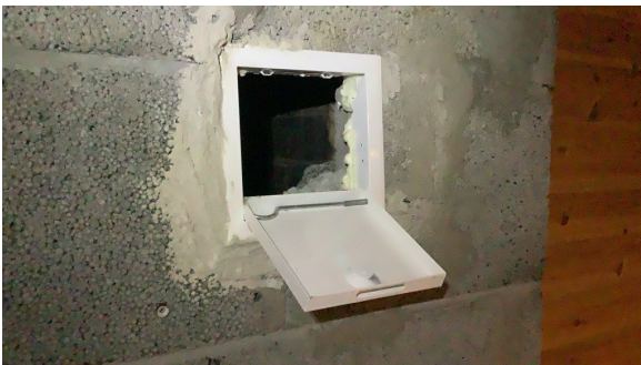
Inspeksjonsluke som sotluke.
