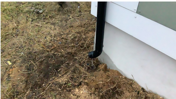
Mangelfull bortledning av takvann.
