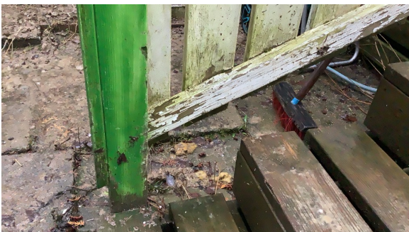
Værslitt rekkverk med store åpninger.
