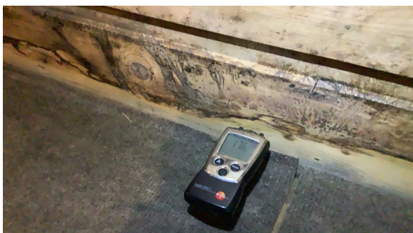
Sopp utvikling på panel i kjellerstue, og det måles tørt i dette området på befaringsdagen
