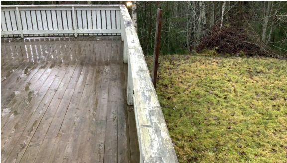
Skjevt, og værslitt rekkverk.
