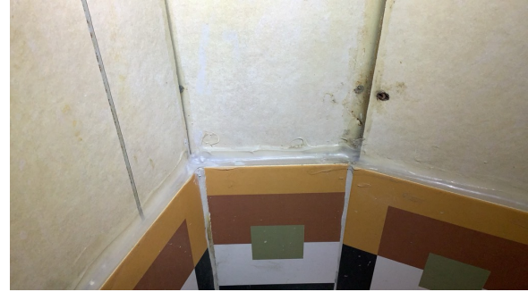
Ufagmessig utførelse av hjørne i dusjnisen, og plater er skrudd fra utsiden.
