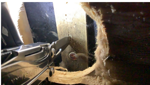
Påforing er råteskadet.
