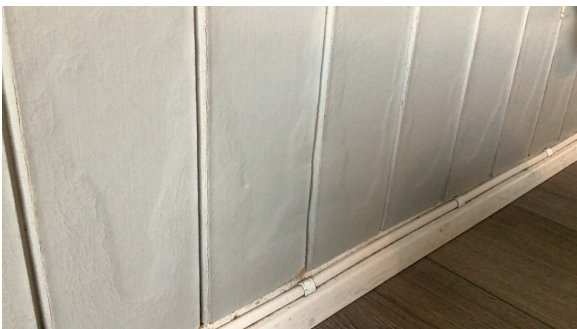
Svellskader i veggplater.
