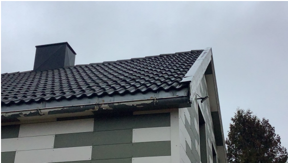
Skjevheter i nederste steinrekke
