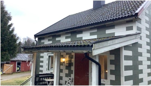
Skjevt tak på inngangsparti.
