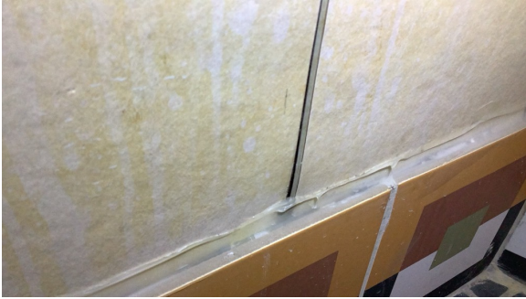
Fuktskadet baderomsplate, og sokkelflis er ført utenpå platen.
