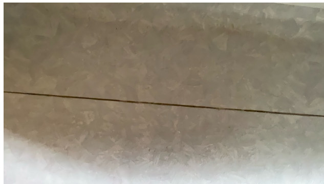
Åpning mellom skjøt gulvbelegg
