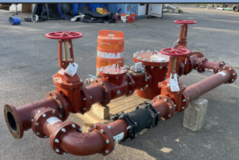
Nuevo medidor principal proporcionará servicio al sistema de agua del campus
