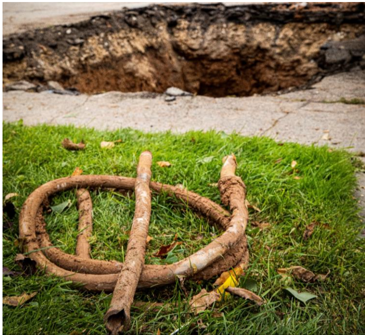
Lead pipes Tuberías de plomo
