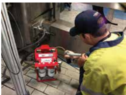
Sistema de Filtración Manual
