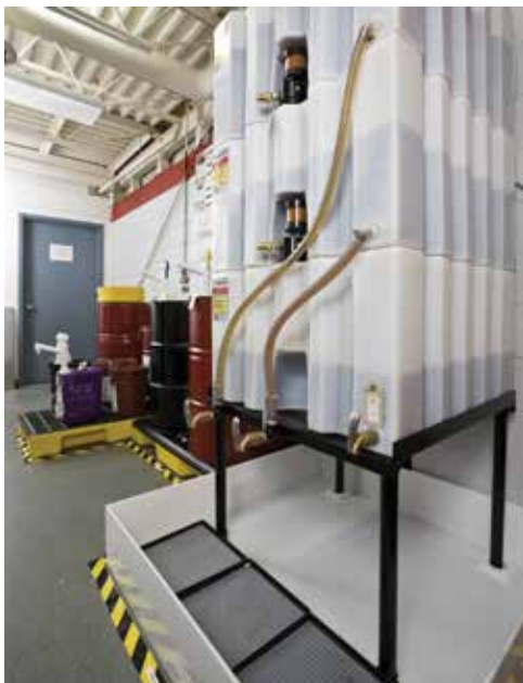
Sistema de Almacenamiento de Aceite a Granel - Plástico
