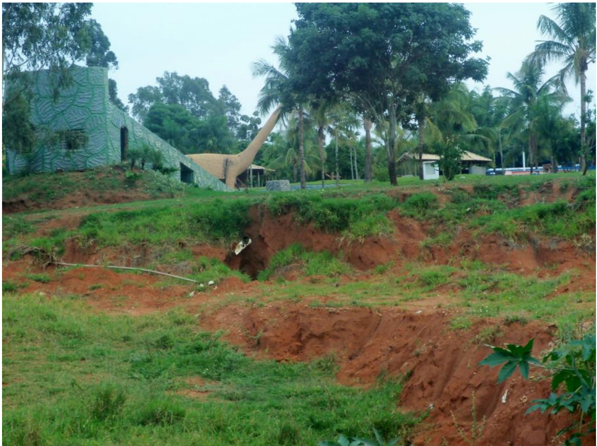
Foto 7 - Saída de água pluvial causando erosão.
