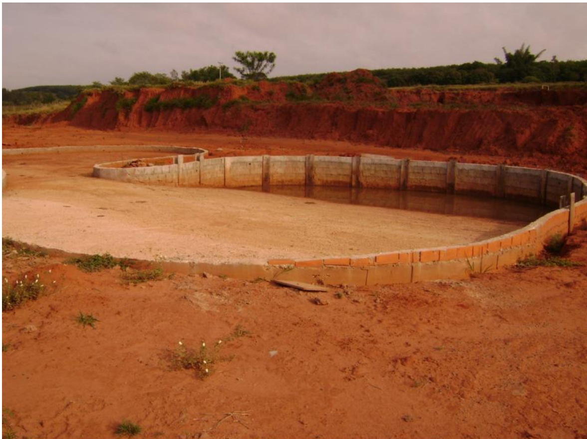
Foto 8 - Solo exposto em obra interrompida.
