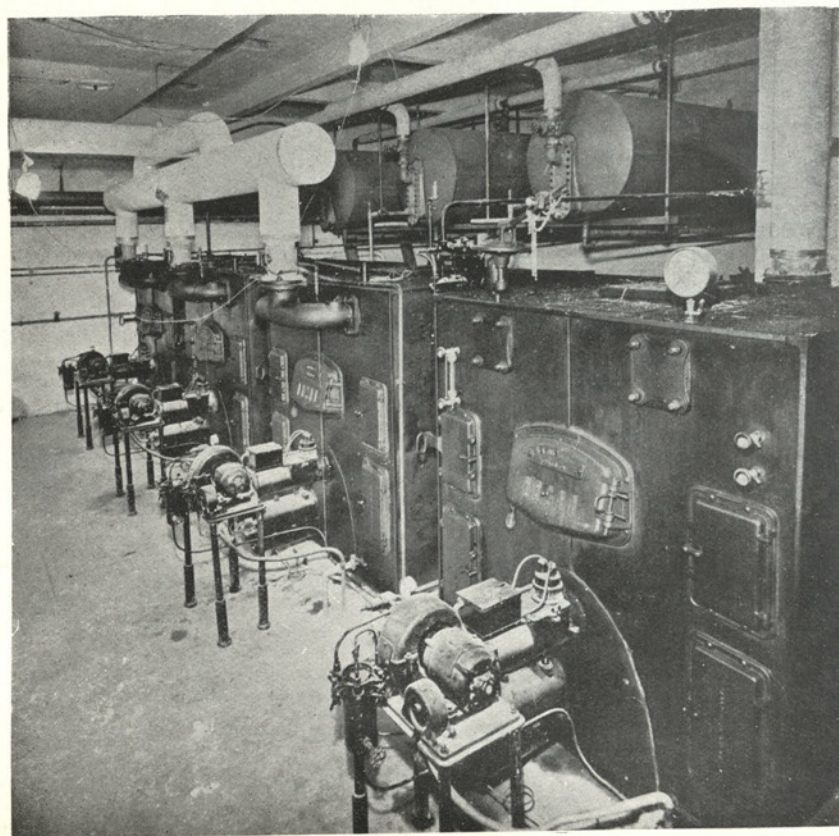
150. SALLE DE CHAUFFE
