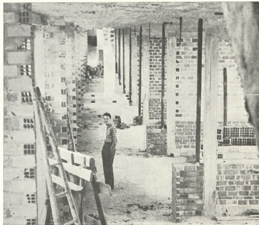
59. LES DESCENTES D'EAU, EXECUTEES EN ACIER SOUDE, ONT ETE INCORPOREES AU BETON ARME OU DANS LES MURS DE REMPLISSAGE
