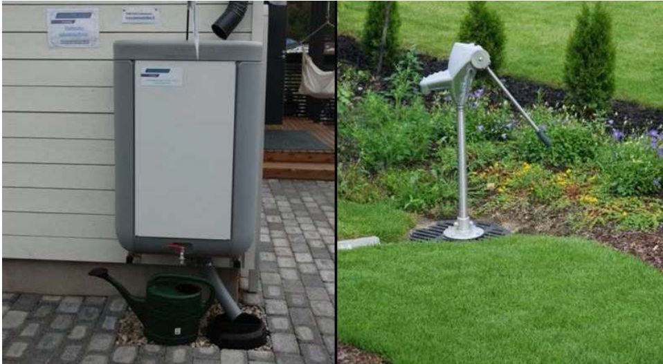
Kuva 3 Vasemmalla kuva 190 l kattovesisäiliöstä. Oikeassa kuvassa tontin hulevesille varattu kaivo, josta vedet on pumpattavissa hyötykäyttöön. (Kuva Tampere, Vuores, FCG)
