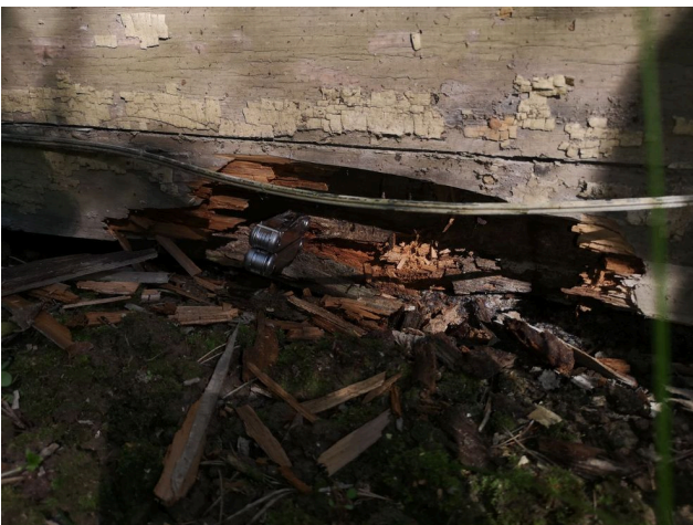
Henri Tissari 06.07.2021 11:30 Kuva 9. Alin hirsi lahovaurioitunut
