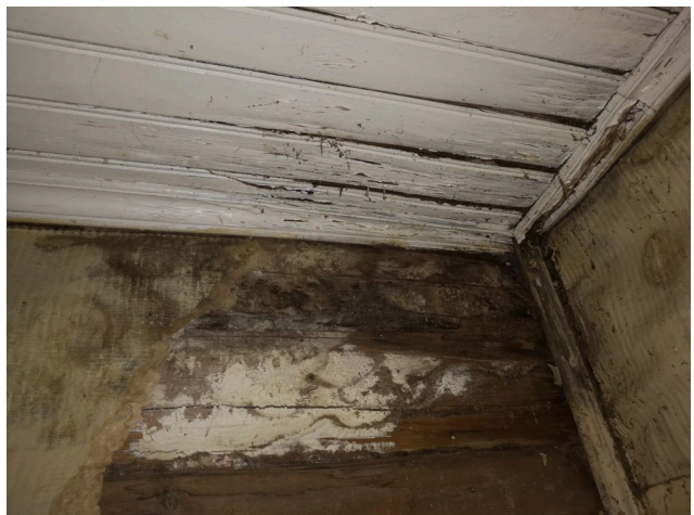
Henri Tissari 06.07.2021 11:30 Kuva 10. Hirsi ja välipohja lahovaurioitunut, hirsessä lahottajasienikasvustoa
