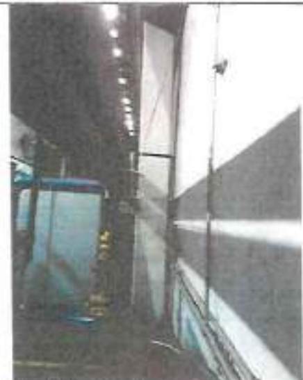
Figura 02 – Interferência para pintura da parede.
