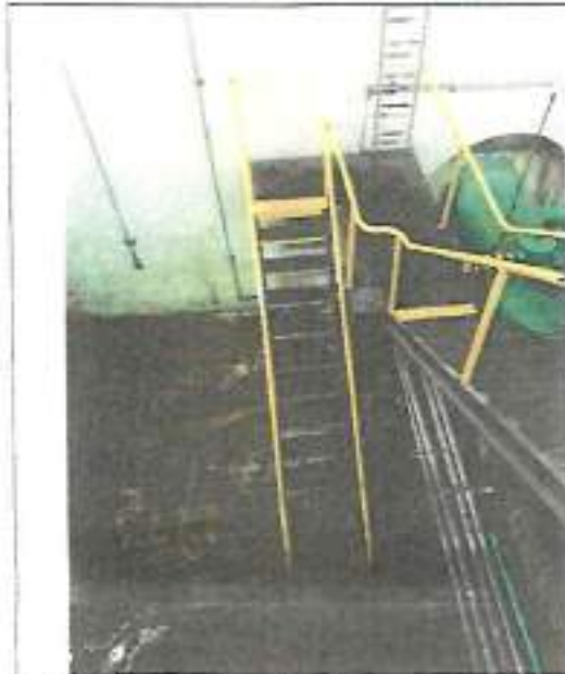
Figura 01 - Segregação do concreto do piso que será regularizado com concreto.
