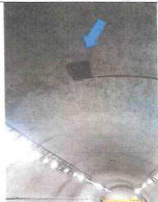
Figura 02 – Revestimento se desprendendo da estrutura.
