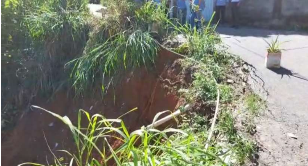
Figura 2: Região a montante da ruptura
