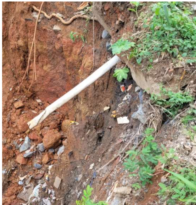
Figura 2: Tubulação de esgoto localizada próxima à crista do Talude
