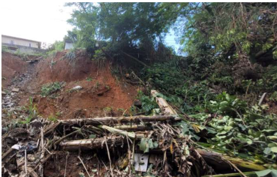
Figura 7: Talude vertical de solo localizado à direita da ruptura
