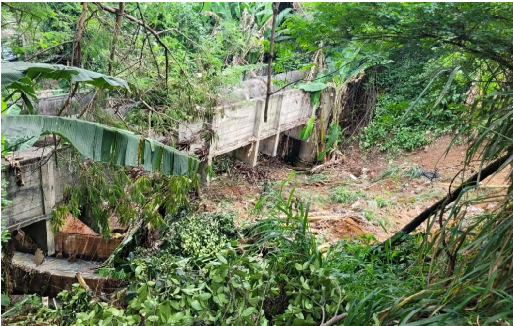
Figura 3: Região a jusante da ruptura
