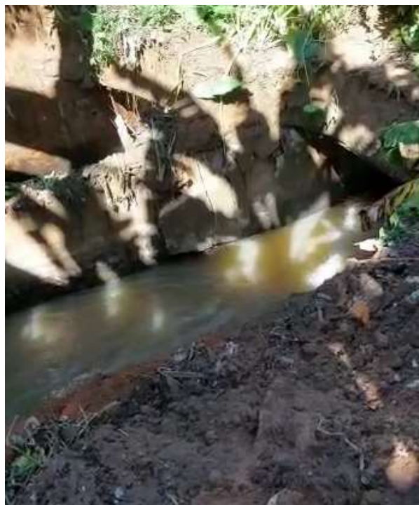
Figura 4: Galeria descoberta pela ruptura da laje superior
