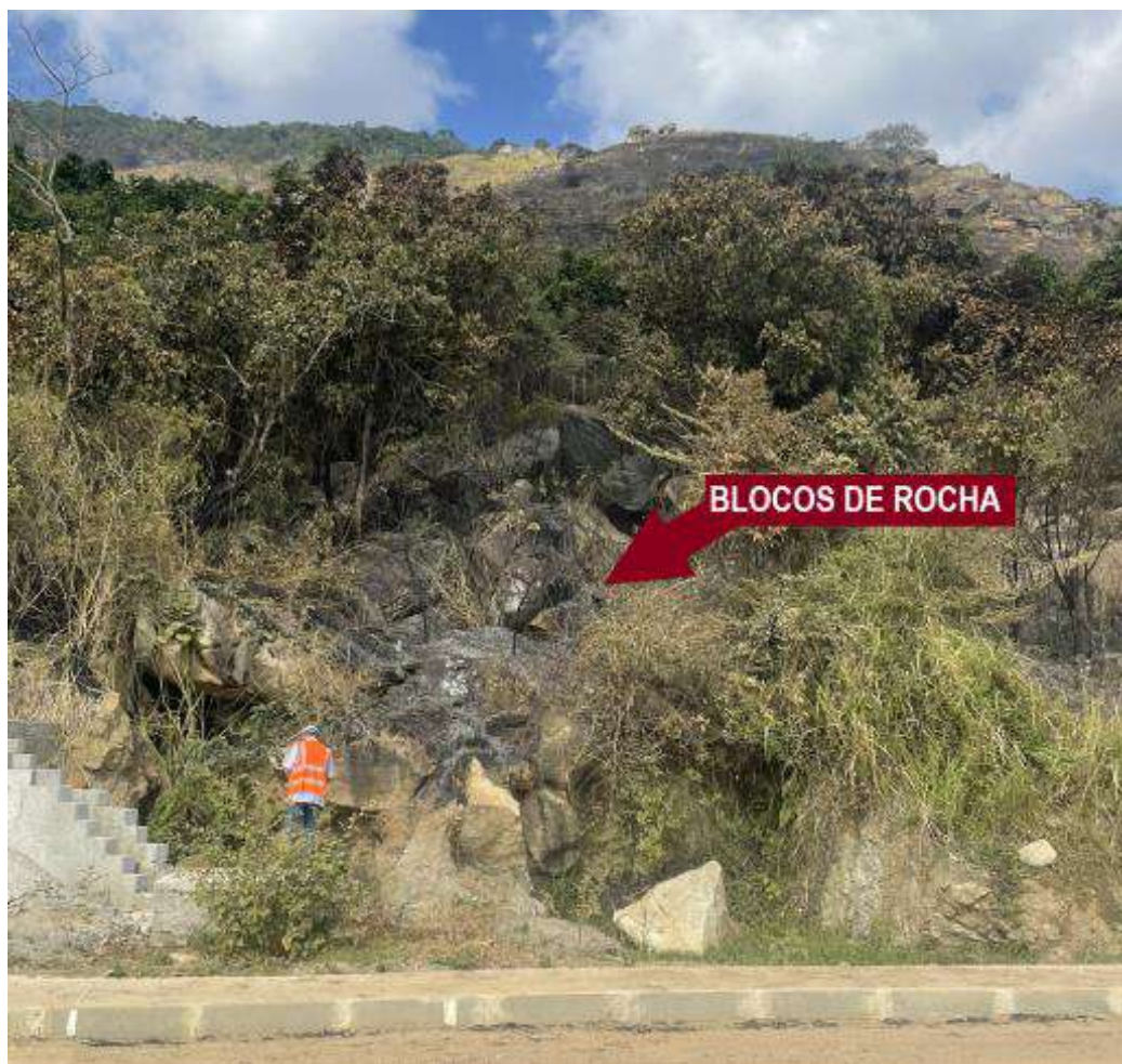
Foto 17 – Talvegue identificado na área 4 com destaque para presença de blocos de rocha que rolaram desde a região de montante
