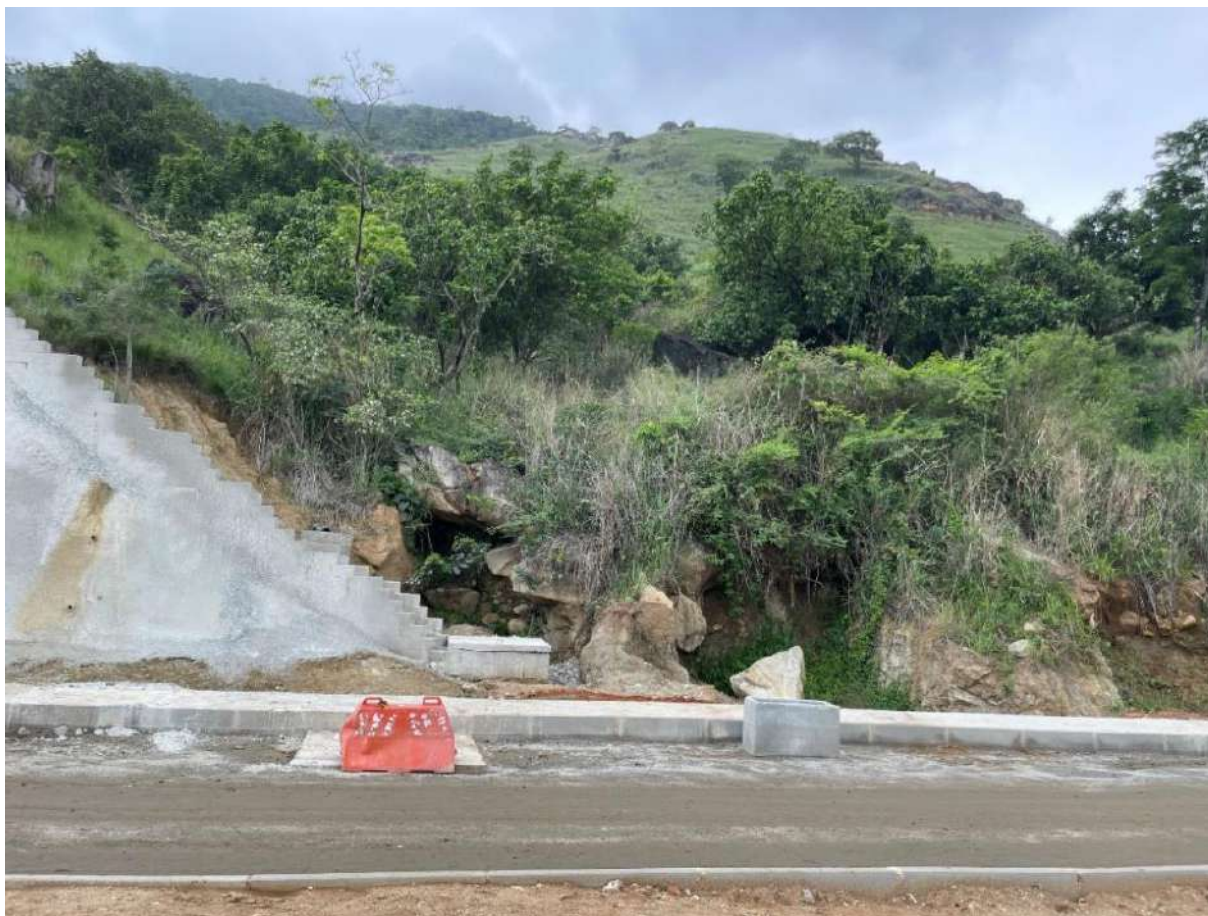
Figura 50- Drenagem da área 4 com depósito de tálus encaixado na base.
