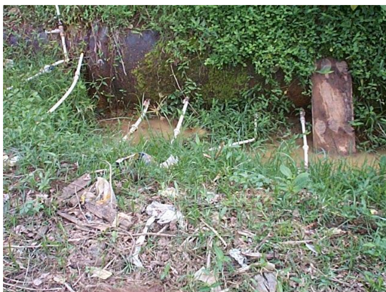
FLAGRANTE DE LIGAÇÕES CLANDESTINAS EM ADUTORA
