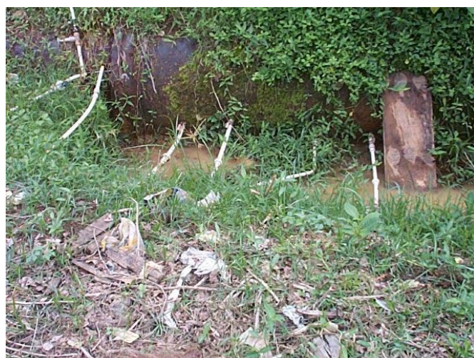
FLAGRANTE DE LIGAÇÕES CLANDESTINAS EM ADUTORA
