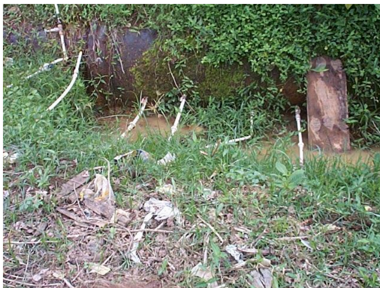
FLAGRANTE DE LIGAÇÕES CLANDESTINAS EM ADUTORA
