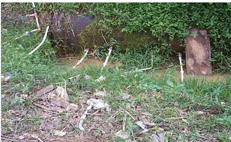
FLAGRANTE DE LIGAÇÕES CLANDESTINAS EM ADUTORA
