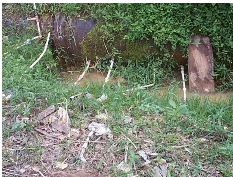
FLAGRANTE DE LIGAÇÕES CLANDESTINAS EM ADUTORA
