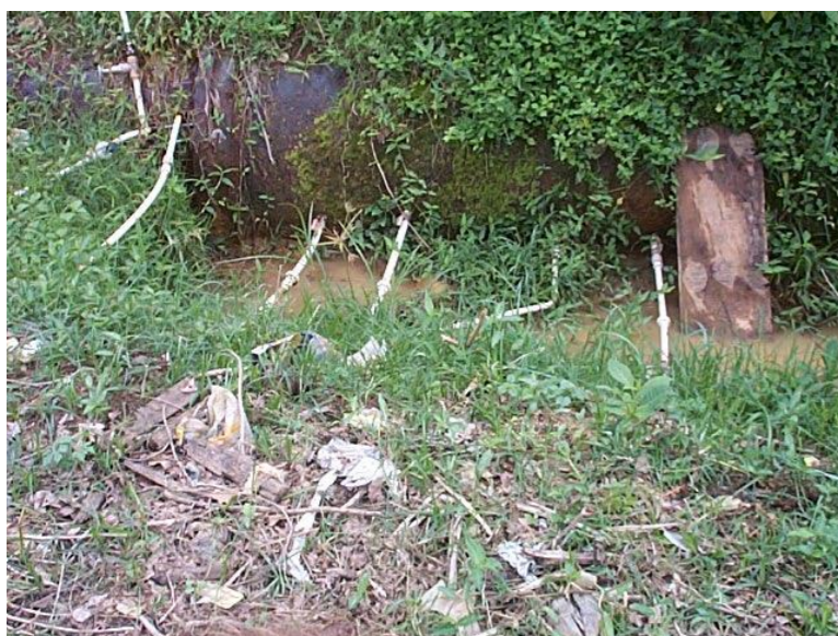
FLAGRANTE DE LIGAÇÕES CLANDESTINAS EM ADUTORA
